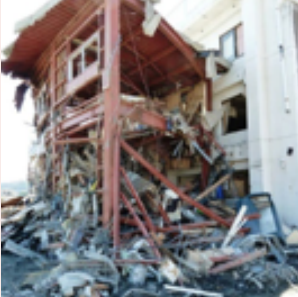
Bangunan beton yang rusak oleh sapuan arus tsunami
